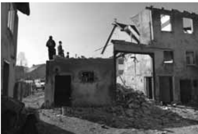
Im Bereich der Ortsflurbereinigung Donnstetten wurden in diesem Jahr zwei leerstehende Gebäude im Bereich der Mörikestraße abgebrochen. Ein Wohnhaus sowie das sogenannte "Schmittle". Die Flurbereinigung
